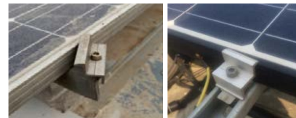
1.3 组件压块未紧固，导致组件跌落损坏
