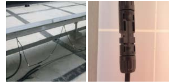
1.4 光伏电缆未绑扎，造成线缆破皮；光伏组串的连接插头连接不紧密，产生直流拉弧；
