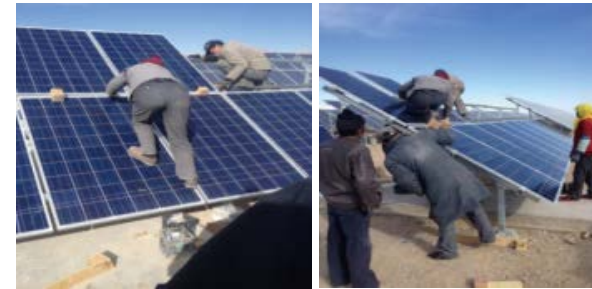
1.1 施工中对组件的踩踏会导致电池片隐裂的产生，严重的会导致组件破裂、失效。
